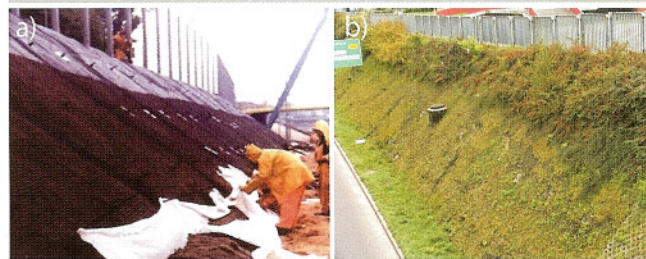
Fot. 7. Skarpy wykopu DTŚ w sąsiedztwie ul. Cichej: a) realizacja projektu; b) stan obecny
